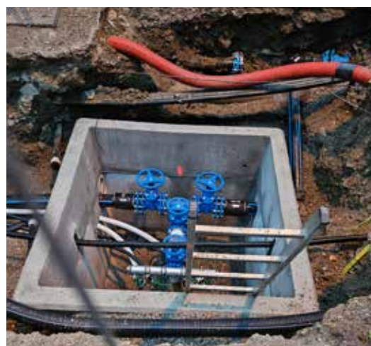
Pozzetto di diramazione con collettore per i privati
