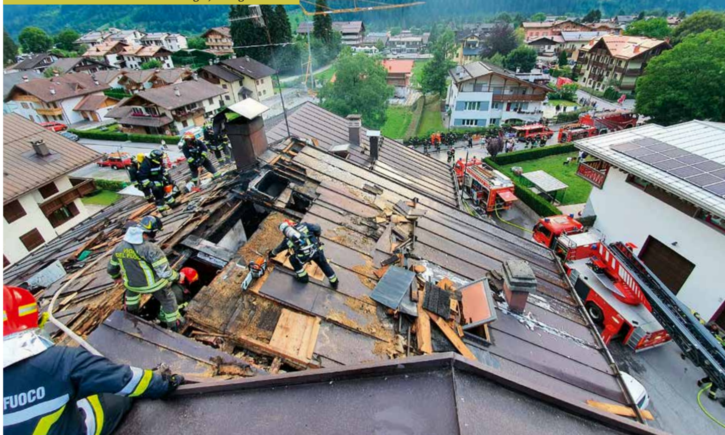
Intervento su incendio in via di Gagia, 17 luglio 2020
